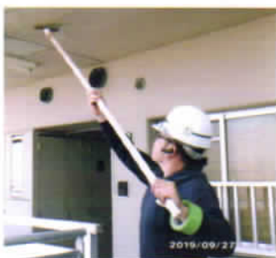
西6号棟通路修繕作業 9月26日 棟玄関のガラスが大きく割れたままになっているので修繕の要望書を提出する予定です。
